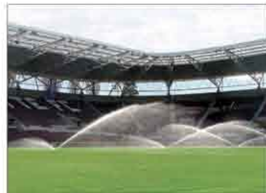
Turbinas Hunter I-41-ON en funcionamiento en el Stade de Genève.
